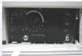
Thermostat, Schalter Beleuchtung
